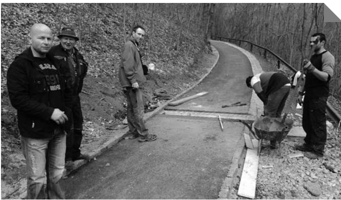
Dokončování žlabu na nové cestě Pod Sady v úseku nad splavem. Na snímku jsou zleva zástupci dodavatelské firmy Herkul pan Petržílek a pan Liška, technický dozor investora zastupuje ing. Dosoudil ■ Foto: V. Dobeš
